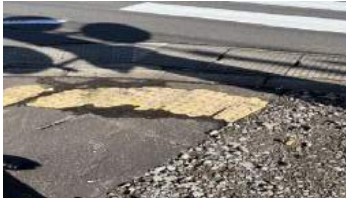
図 13 大館市における劣化の激しい点字ブロック② (撮影：WSD)
