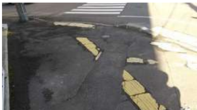
図12 大館市における劣化の激しい点字ブロック① (撮影：WSD)
